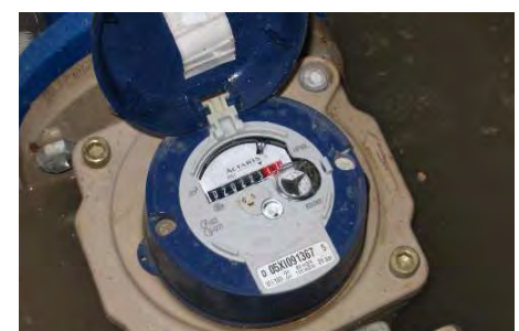
Compteur d'eau potable
