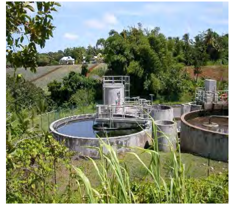
Bassin de décantation d'une station d'épuration
